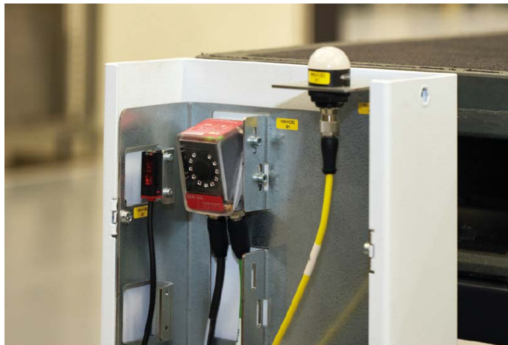
Sensortechnik von Leuze an einer Docking-Station im Detail: Unter der geöffneten Abdeckung ist links ein HT5.1/4X zur Anwesenheitserkennung der Palette installiert. Der kamerabasierte Codeleser DCR202iC daneben erfasst Auftrags- und Materialdaten über den 2D-Code der Palette. Das Signallicht rechts informiert über den aktuellen Status per Farbsignal.
