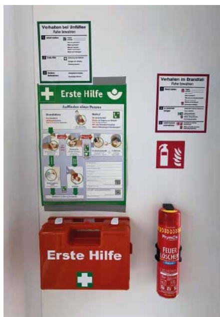
Prymos Feuerlösch-Spray als Schutz in einer Corona-Teststation im Raum Köln
