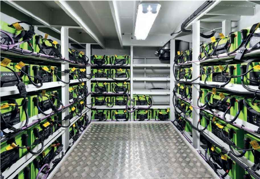
Die Akkus sind in einem eigenen Batterieraum untergebracht und fassen insgesamt eine Kapazität von 80 kWh.
