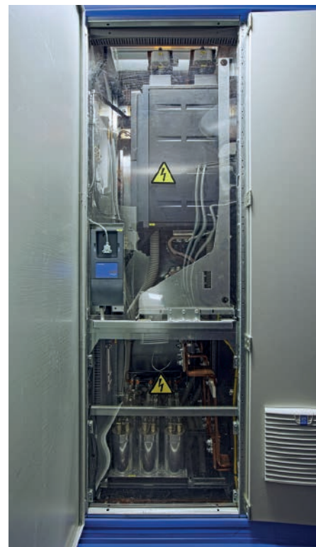
Das System verfügt über Active-Front-End-Einheit, die die notwendige Energie in das System einspeist, aber auch beim Bremsen generatorisch erzeugte Energie wieder ins Netz zurückschiebt. Sie speist den Zwischenkreis, der die sechs angeschlossenen Umrichter-Einheiten versorgt.
