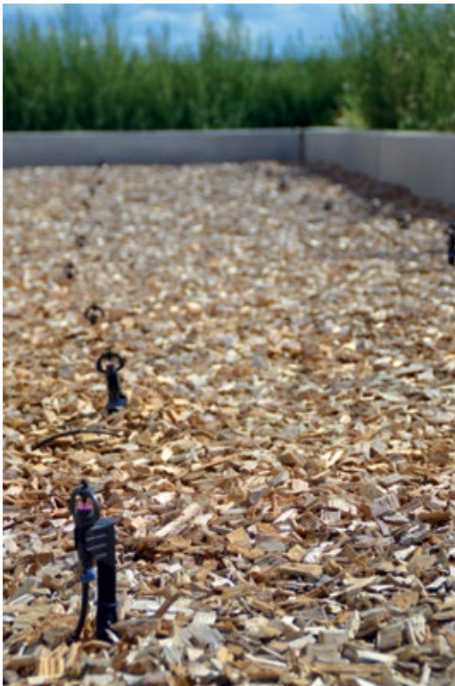
In den Filterwannen liegen die Häcksel – eine Berieselungsanlage sorgt für konstante Feuchtigkeit.
