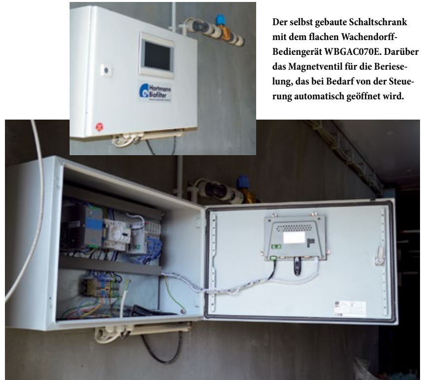
Im Inneren des Schaltschranks: der leistungsstarke Controller NA9371 des FnIO-Systems von Wachendorff.
