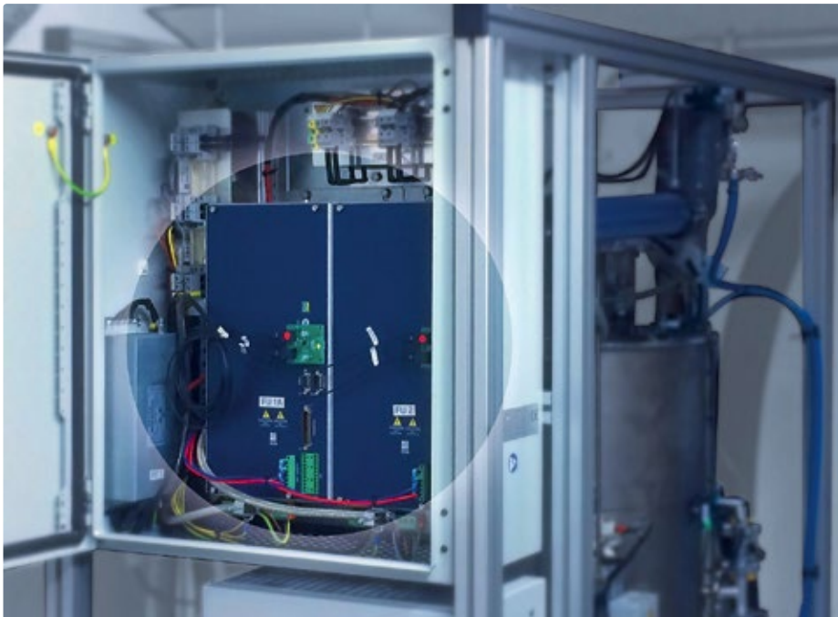
Der Antrieb der Turboverdichter der Kompressionskältemaschine eChiller erfolgt über Synchronmotoren, die ihren Strom von zwei SD2S-Frequenzumrichtern beziehen.
