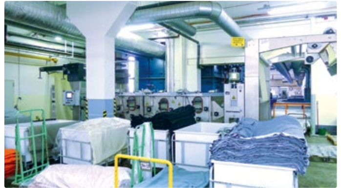
Auch kleine Stoffmengen müssen effizient gewaschen werden. Die mit Antriebstechnik von Lenze ausgerüstete CompactFlow ist genau darauf ausgerichtet.
