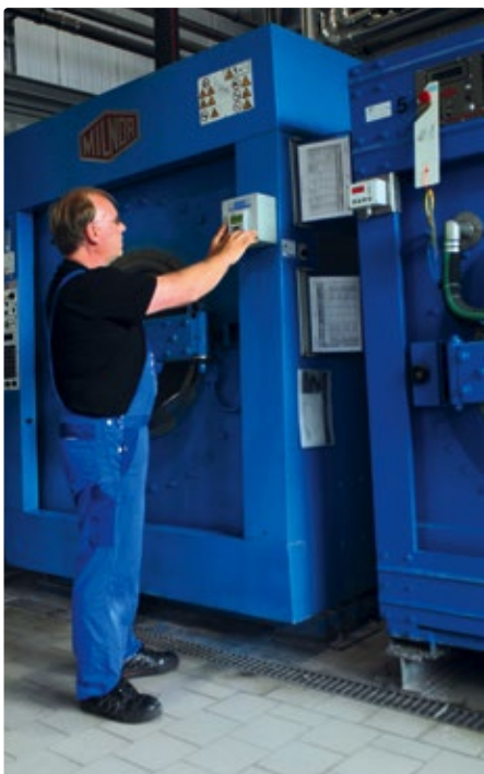
Die Steuerungslösung ermöglicht die einfache Nachrüstung von älteren und neuen Milnor-Waschmaschinen Frank Dräger, verantwortlicher Projektmanager bei Ott, ist überzeugt von der easy-Technologie.
