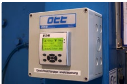
Über das MFD-Titan kann der Bediener die Füllmenge der Waschmaschinen mit gewichtsabhängiger Levelsteuerung bestätigen und so den Waschvorgang starten.
