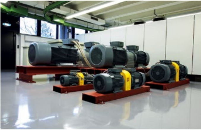
Danfoss testet vor Ort in Offenbach große Leistungen unter Last.
