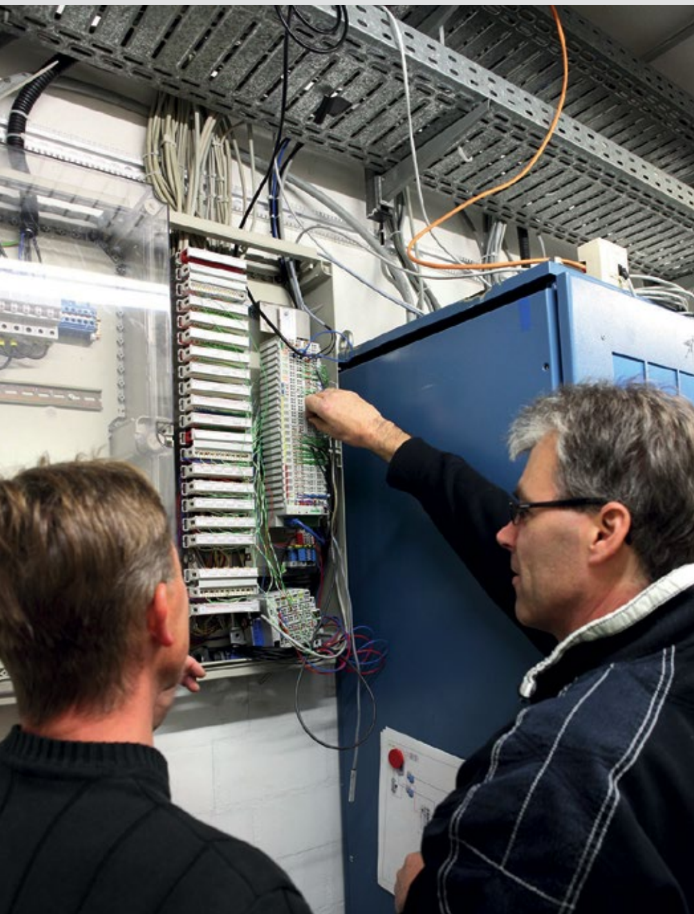
◀ Kay Petermann (l.) und Bernd Janku (r.) von der Abteilung Signal- und Fernmeldetechnik an der Teststeuerung im BHKW.
