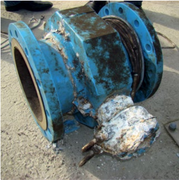
Nach einem Jahr Messbetrieb zeigte die erste Sensorinstallation mit Promag 50W IP68 deutliche Spuren von Korrosion.
