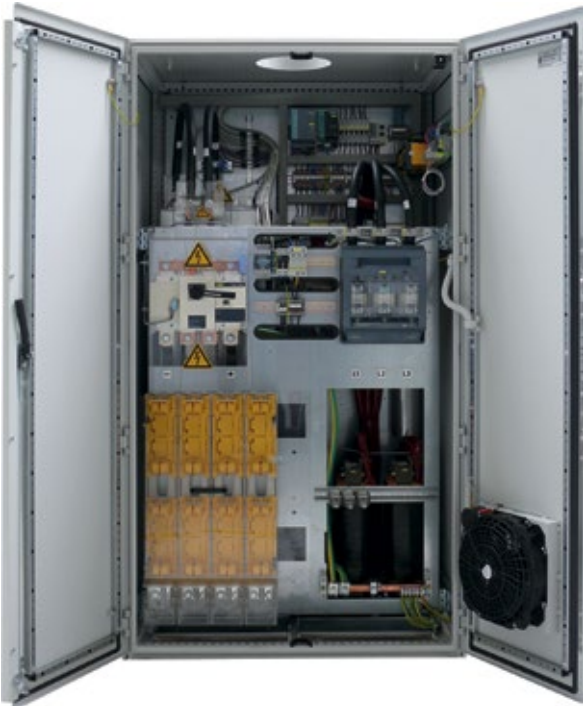
Ein LTI-Wechselrichter des Typs PVmaster II EM: Hoher Wirkungsgrad und widerstandsfähige Kühlsysteme überzeugen im Solarkraftwerk im belgischen Zelzate.
