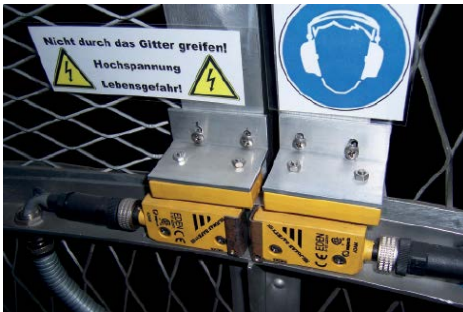
Die berührungslos wirkenden Sicherheitssensoren Eden überwachen Fenster und Türen der Faradaykugel.
