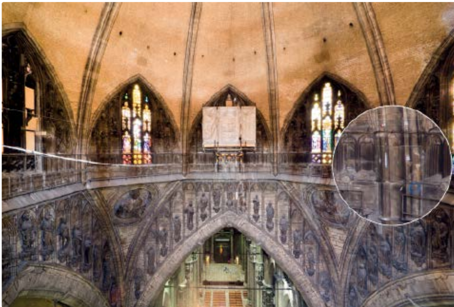
Acht optische Dehnungsmessstreifen – an jeder Rippe einer – erfassen, ob sich die Kuppel verformt. Jedem Dehnungsmessstreifen ist dabei ein FBG-Sensor zum Temperatureingleich zugeordnet.
