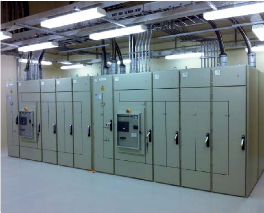
Mit vier 10-MW-Sanftanlassern wird die Druckerhöhungsanlage der Ölpumpstation betrieben. Im Schaltschrank verbirgt sich die SPS-Funktionalität, die sowohl Steuer- und Kontroll- als auch Schutzfunktionen übernimmt.
