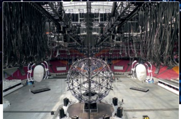
Die aufwendige Technik der Showsteuerung für die Sensation 2012 wurde unter dem Dach der Amsterdam Arena montiert.
