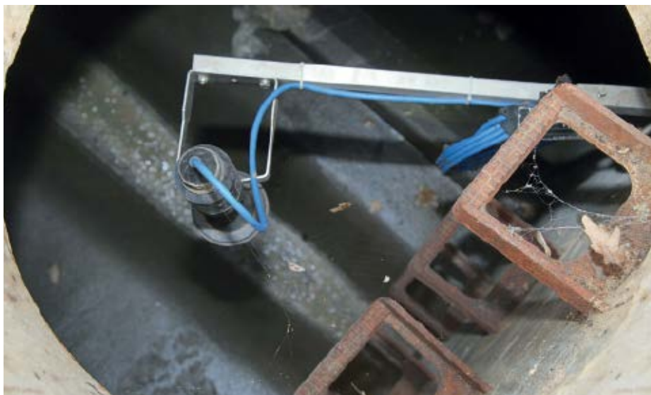
Die Radarmessgeräte wurden in Schutzart IP 68 ausgeführt, da der Schacht des Schmutzwasserpumpwerks in einem Hochwasser gefährdeten Gebiet liegt.
