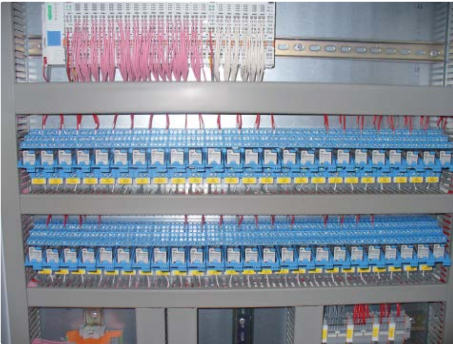
Koppelrelais schalten die Verbraucher innerhalb der Biogasanlage.
