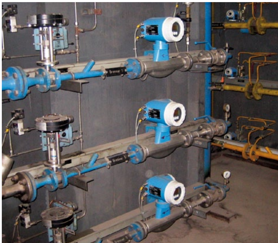
Drei Coriolis-Messgeräte Promass F zur Massemessung des Sauerstoffs am Brenner (im Hintergrund Blendenmessungen).
