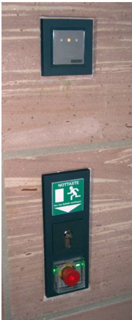
Zutrittskontroll- und Flucht- und Rettungsweglösung mit der Türzentrale TZ 320
