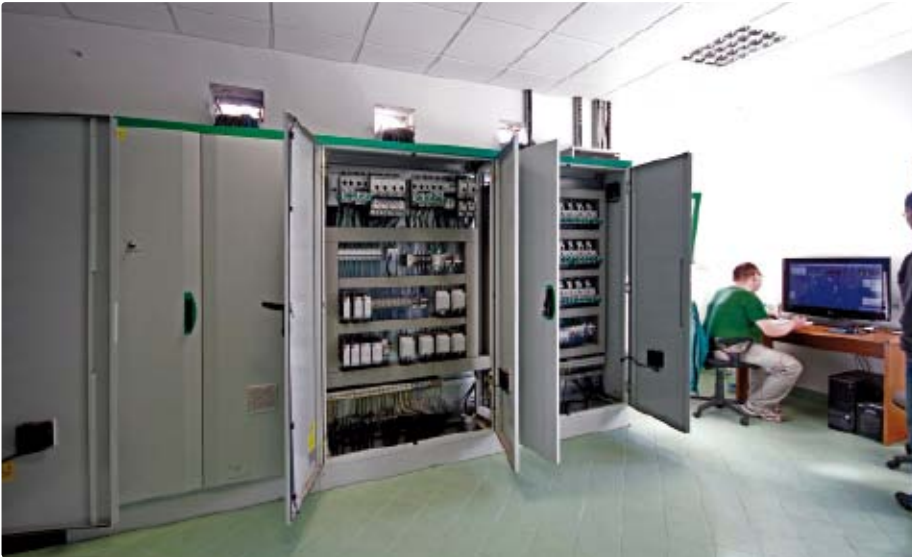
Ordnung im Schaltschrank: Dank SmartWire-DT, dem Verbindungs- und Kommunikationssystem von Eaton, entfallen die aufwändigen Punkt-zu-Punkt-Verdrahtungen, stattdessen wird die standardisierte „grüne“ Leitungsverbindung genutzt.
