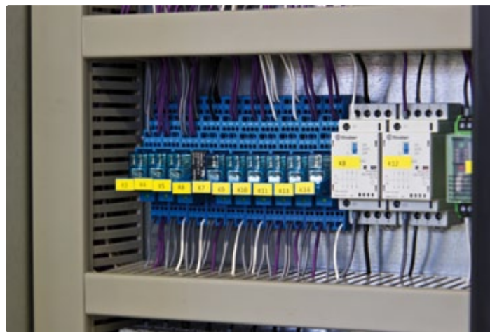
Die Relais schalten die verschiedenen Verbraucher sowie das Förderband in der Kommissionieranlage.
