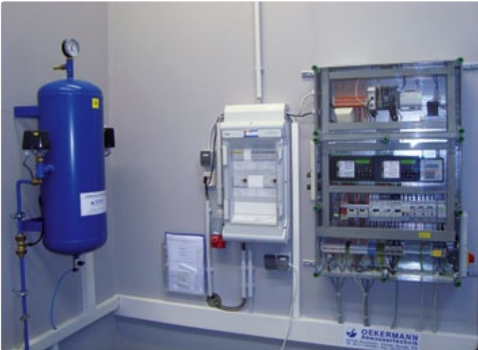
Der elektrische Schaltschrank und die pneumatische Steuerung regeln die bedarfsgerechte Abwasserentsorgung.
