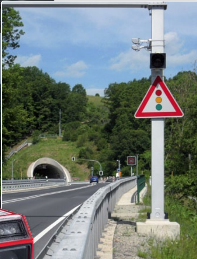
Die Lichtschranken sind zweifach installiert, sodass jedes zu hohe Fahrzeug zuverlässig erkannt wird.
