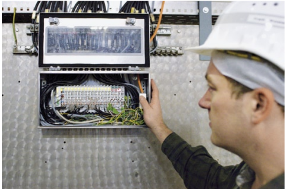
Abb. 5: „Wir haben mit den eingesetzten Komponenten von Wago für das Condition Monitoring eine sehr flexible Lösung gefunden mit einem sehr guten Kosten-/Nutzenverhältnis“, bewertet Frank Weishäupl, vom Industrial Engineering der Nordzucker AG, den erreichten Anlagenstand.
