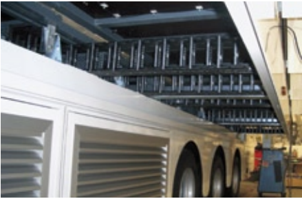
Abb. 3: Aus Platzgründen sind zwei Energieführungsketten ineinanderlaufend um 90° gedreht angeordnet
