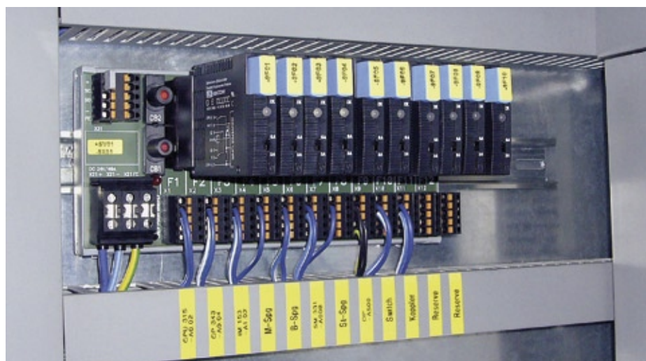
Abb. 3: Ordnung im Schaltschrank auf engstem Raum: RAG nutzt das DC 24 V-Absicherungskonzept von E-T-A.
