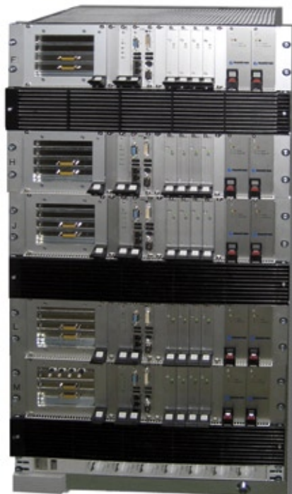
Abb. 1: Die VDEC-Einheiten in der Leitwarte
