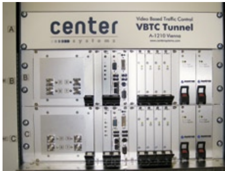
Abb. 5: Der Systemaufbau der VBTC Tunnel VESA-Einheiten von links nach rechts: PCI-basierte Framegrabber-Karten, RAID-Controller, Kontron CP-307 CPU-Board, vier Festplatteneinschübe sowie zwei Netzteile.
