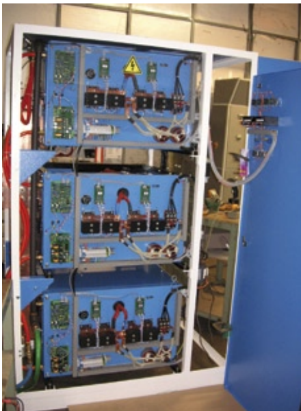
Abb. 1: Vorderansicht des kompakten Kraftwerks
