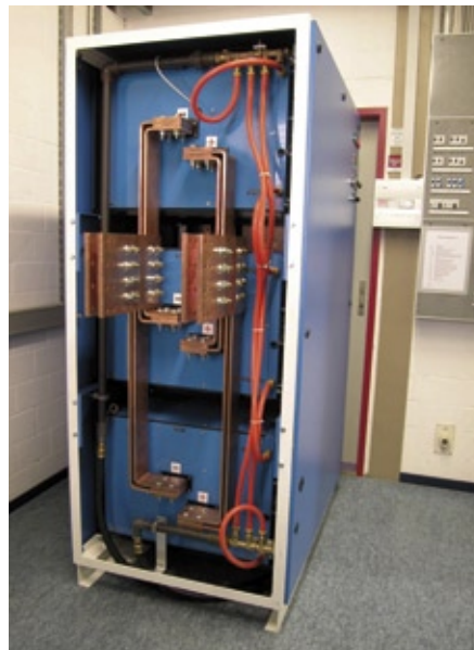
Abb. 2: Über diese gewaltigen Stromschienen fließen bis zu 15.000 A.
