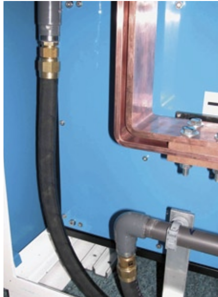
Abb. 3: Nur mit Wasserkühlung können 180 kW in einem Volumen von nur 2,2 m 3 realisiert werden.
