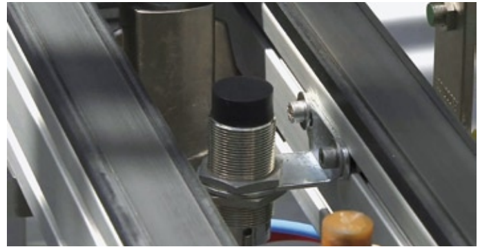
Abb. 3: Schreib-/Leseköpfe befinden sich an allen relevanten Stellen der Transportstrecke.
