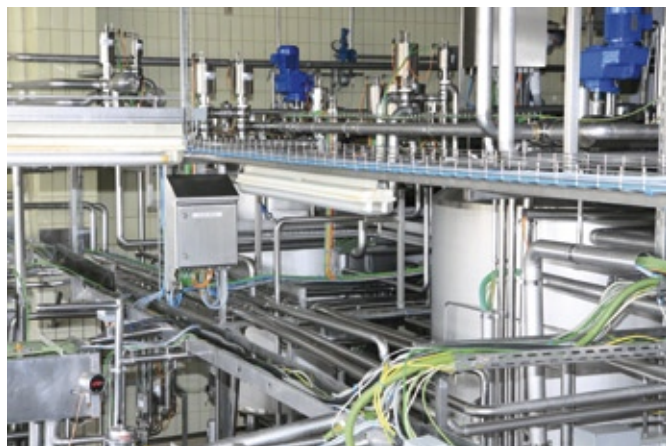
Abb. 2: Die Hygienic Design (HD) Lösungen von Rittal bieten dafür optimale Voraussetzungen für rückstandsfreie Reinigung: Hier im dezentralen Einsatz mitten in Herstellung von Hüttenkäse.
