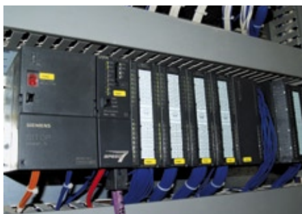
Abb. 4: Eine der im neuen Werk Markgrafneusiedl von Fischer Brot eingesetzten Speed7 315-CPU's: Der Mischbetrieb mit Siemens-Baugruppen – wie hier im Bild mit dem Stromversorgungsgerät Sitop – funktioniert problemlos.
