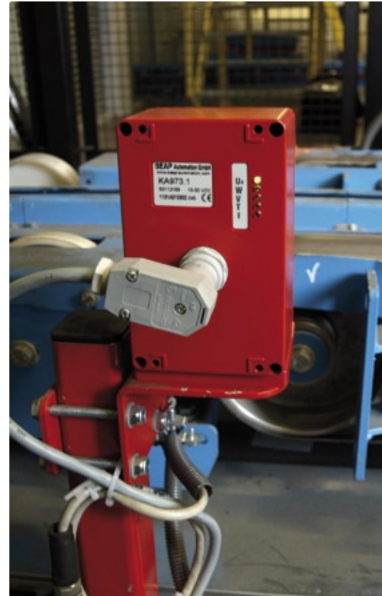
An der Rückseite der Lesestationen werden per LED die Betriebszustände angezeigt.
