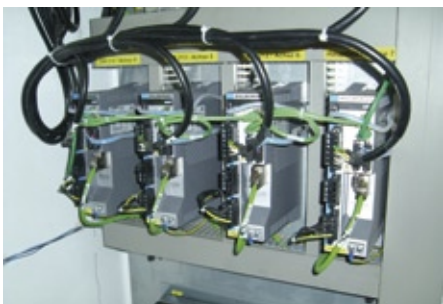
Die verbauten Servoverstärker der AKD-Reihe sind dynamischer als die alten Drives. Jede Abweichung wird sofort korrigiert, die Druckqualität ist gestiegen.
