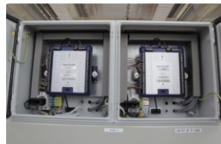
Jeweils zwei Expert Key-Geräte pro Waschmaschinen-Brücke können Wassertemperatur und -verbrauch von bis zu 16 Maschinen aufzeichnen.
