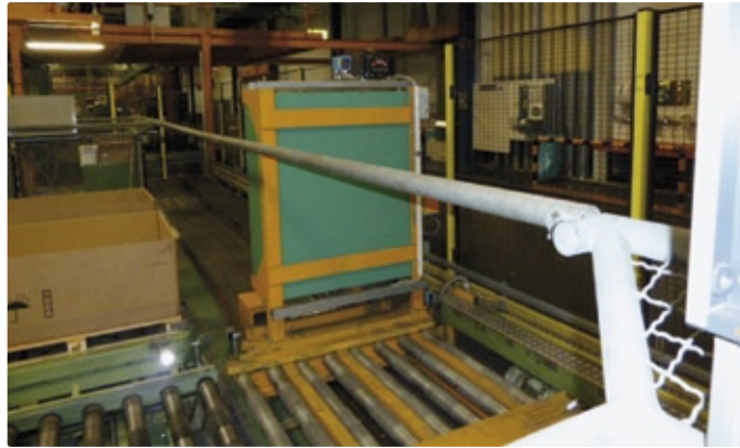
Verschiebewagen übernehmen das automatische Ein- und Auslagerung von Kfz-Ersatzteilen.
