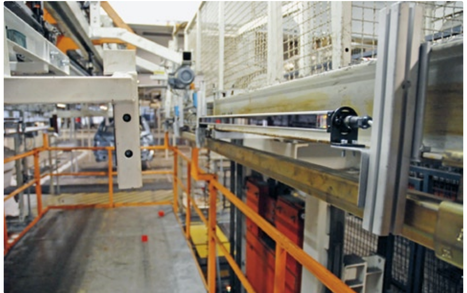
Im Modbus-RTU-Protokoll gelangen die Daten der Lichtvorhänge zu Turcks IP67-I/O-System BL67, wo sie von einem programmierbaren Gateway ins Modbus-TCP-Format gewandelt und an die Steuerung weitergeleitet werden.
