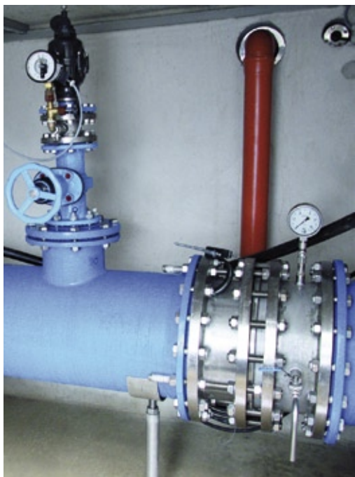
Einspeiseschacht mit Druckregelarmaturen
