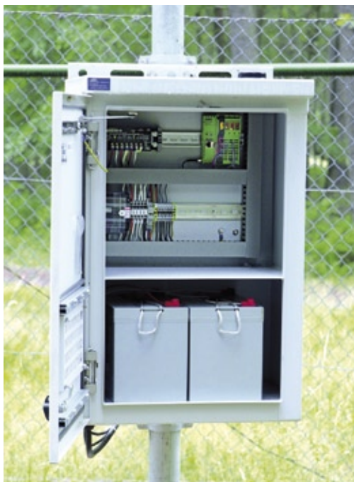
Der vorinstallierte Schaltschrank minimiert den Verdrahtungsaufwand der Solaranlage
