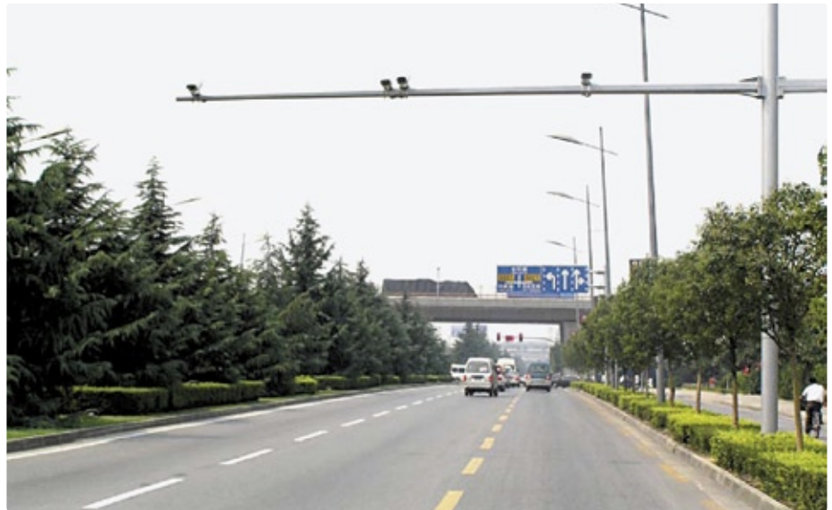
Typische Installation an einem Check-Point
