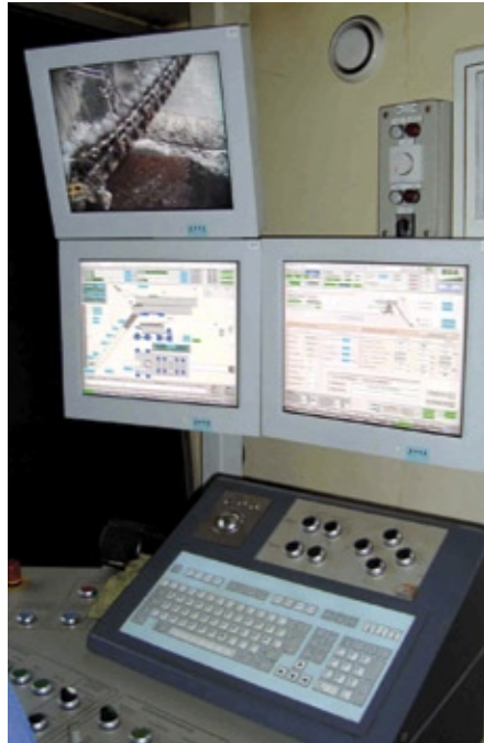
Im Baggerführerstand laufen alle relevanten Zustands- und Betriebsdaten aus den Diagnose- und Visualisierungssystemen zusammen.
