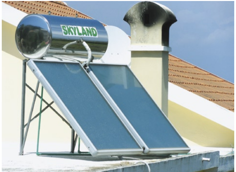
Abb. 2: Der Wasserbehälter einer Thermosiphon-Anlage befindet sich oberhalb des Kollektors (Bild: Hochschule Ingolstadt)
