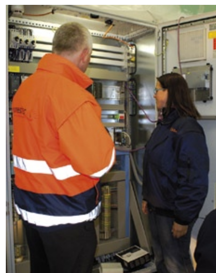
Verena Wieling von der Firma BD AgroRenewables nimmt die Anlage in Betrieb. Im Schaltschrank sorgt eine SPS von Siemens für die Steuerung der gesamten Technik – direkt an sie angebunden ist das Fernwirkmodul eWON aus dem Hause Wachendorff.
