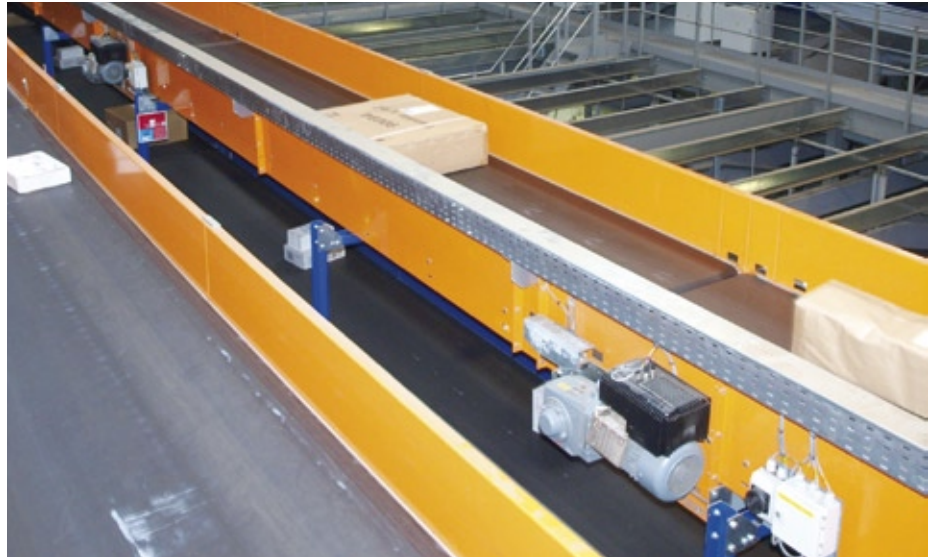
Jeder Gurtförderer ist mit einem Nord-Getriebemotor mit dezentraler Drehzahlregelung ausgestattet.
