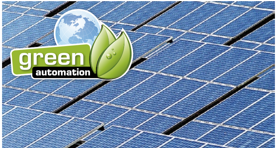
Photovoltaikanlagen sind in Deutschland keine Seltenheit. Nur bei hoher Qualität erreichen sie den gewünschten Wirkungsgrad.
