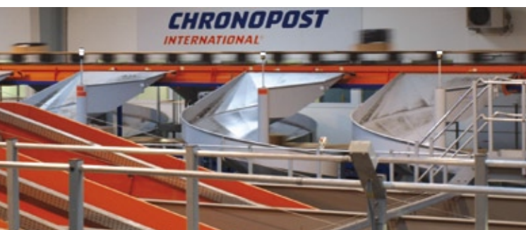
Paket-Umschlagzentrum: 1.100 Antriebe – S. 44
