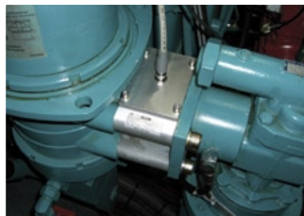
MCS im Filter-Kühl-Schmier-System, links Filter, mitte MCS rechts Pumpe.
