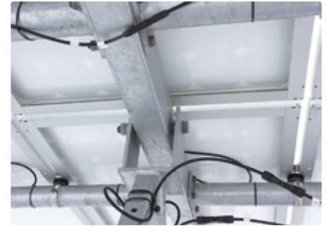
Stahlbau-Systeme sind nicht immer auf den letzten Millimeter ausgerichtet. Dabei entstehen hohe Kräfte, die die Kunststoff-Gleitlager aushalten müssen. (Quelle: igus GmbH, Köln)
