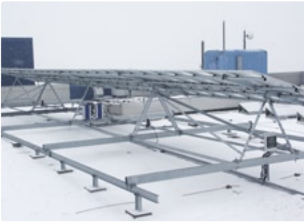
Solar-Nachführsystem s:track von RWenergy in wagerechter Mittagsstellung. (Quelle: igus GmbH, Köln)
