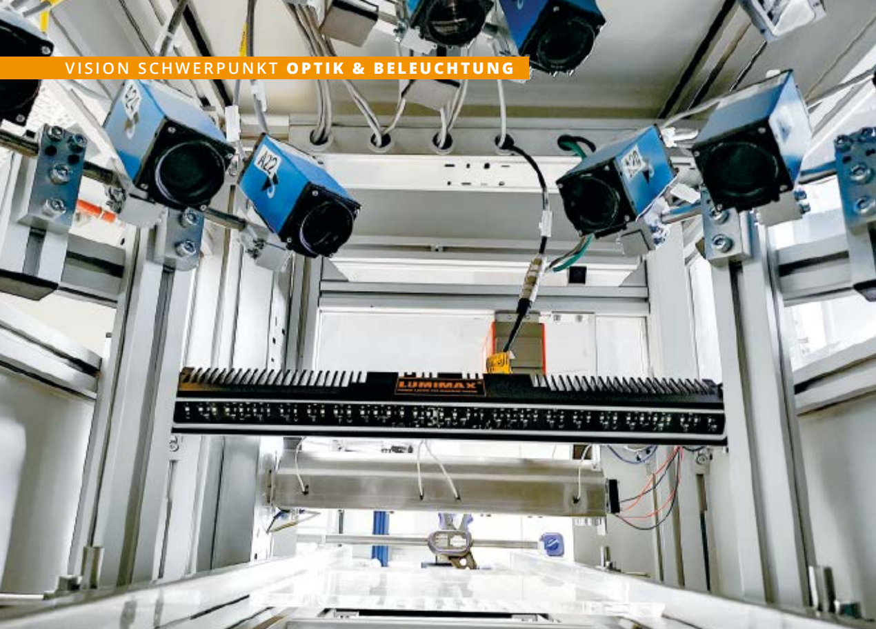
◀ Kamera- und Beleuchtungskonzept der Demonstrationsanlage
