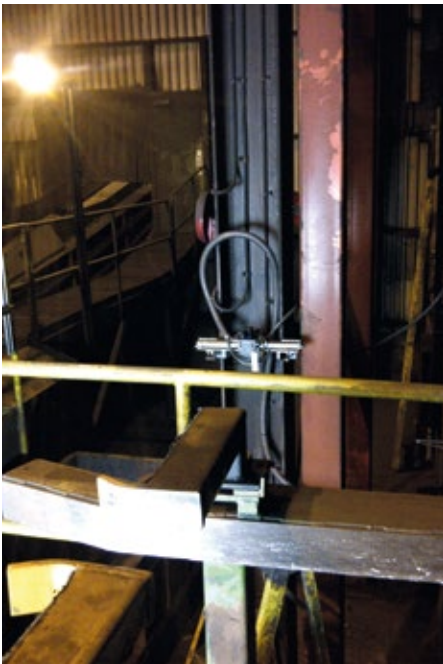
In rauer Umgebung inspizieren zwei Boa-Smart-kamerasysteme von Teledyne Dalsa den Anodenrahmen vor und nach dem Abbrechen der Restkohle und verhindern damit potenzielle Ausfallzeiten.
