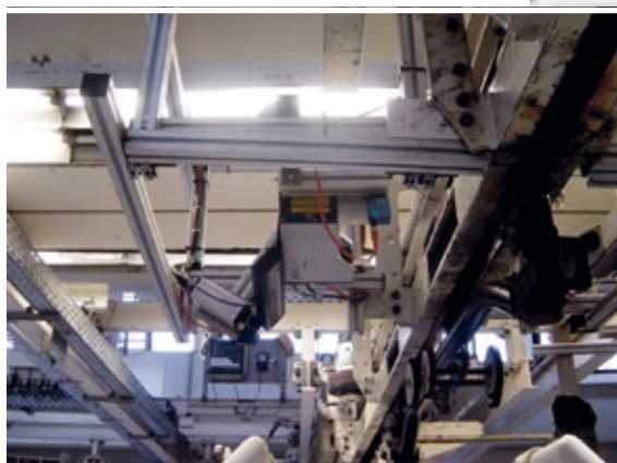
Die 3D-Kameras (Bildmitte) bilden das Herzstück ▼ der Inlinekontrolle. © PSI Technics Ltd.
