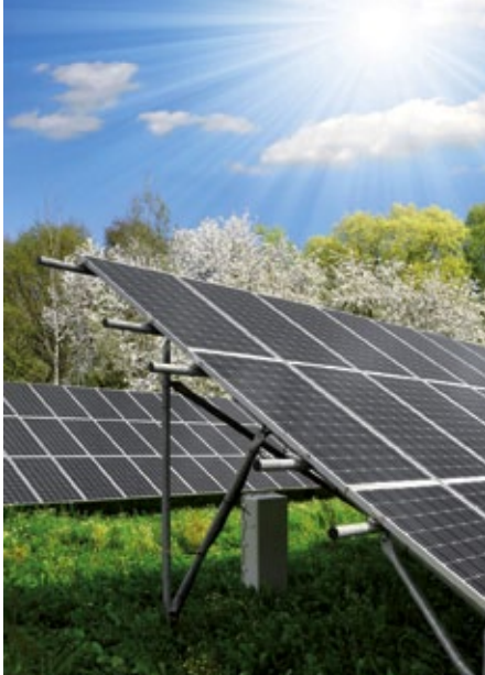
Fehlersuche an Solarmodulen
