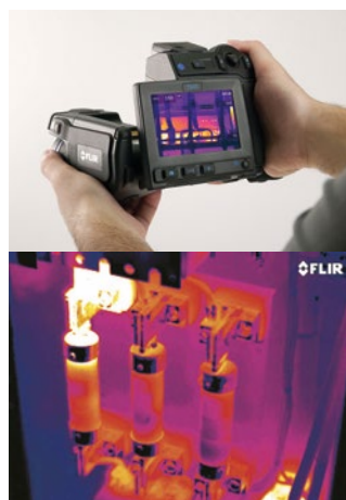
Abb. 4: Neben den Komponenten elektrischer Anlagen lassen sich noch zahlreiche andere technische Systeme mit einer Wärmebildkamera einfach untersuchen.
