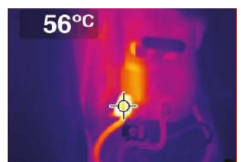
Das zeigt eine Wärmebildkamera.
